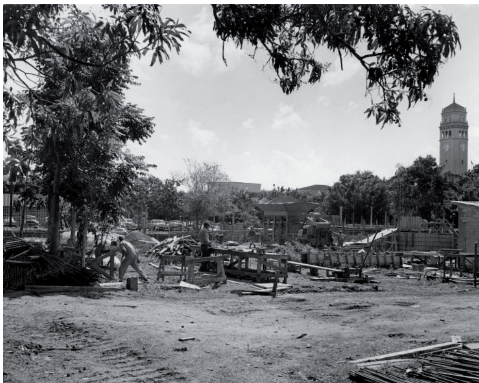
Construcción del Museo de la Universidad de Puerto Rico, 2 de diciembre de 1957. Archivo Universitario, Decanato de Administración, Universidad de Puerto Rico, Recinto de Río Piedras.
