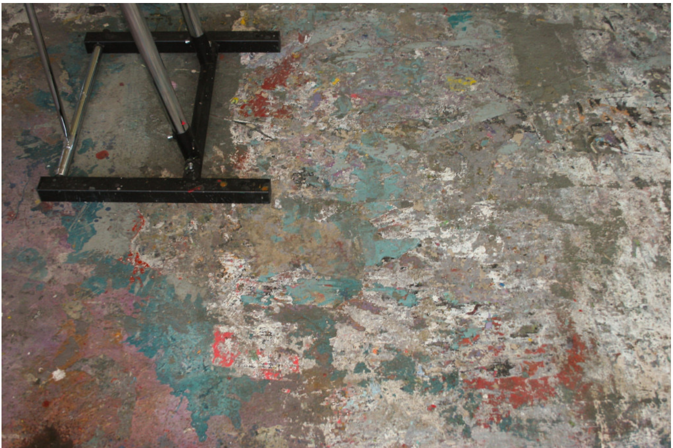
Detalle del suelo del salón de pintura del Departamento de Bellas Artes de la UPR.
